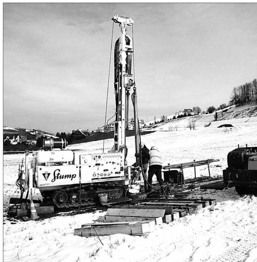
Sondierbohrungen beim Bergweg für den Abschnitt 2 der Südumfahrung im Februar 2009. Foto: zvg
